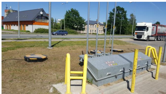
4.4. att. Pazemes tvertņu uzpildes mezgls
