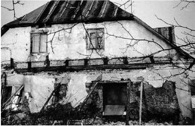
Baltā māja 1999.gadā – lai neizgāztos mājas siena, to nācās atstāt ar koka stutēm /Foto: no „Baltās mājas” arhīva/
